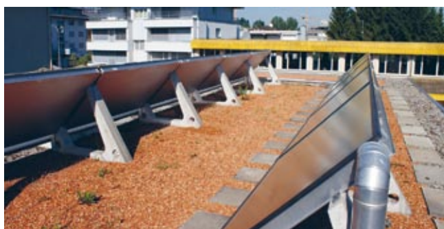
Solarmodule auf Betonaufständung angebaut. Gehwegplatten schützen das Abdichtungssystem bei Wartungs- und Unterhaltsarbeiten an den Modulen.
